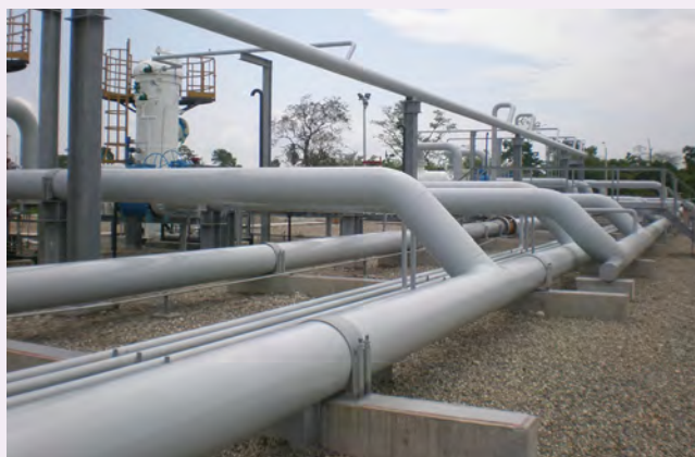
Estación de compresión Hato Nuevo
