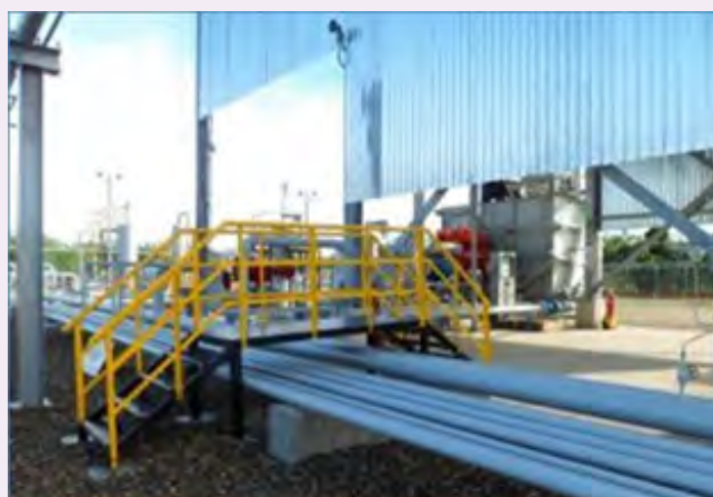
Rack de tuberías succión y descarga unidades de compresión Estación Mariquita
