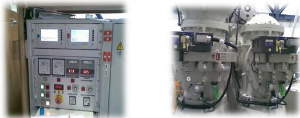
Foto 2.1 y Foto 2.2 Equipos asociados a subestaciones encapsuladas del tipo GIS
