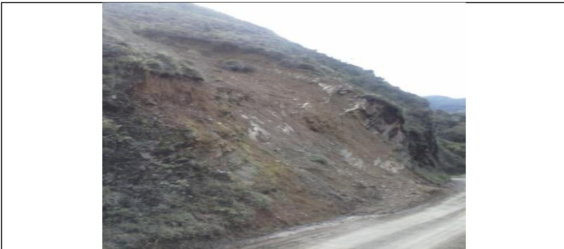
Fotografía 3-15 Remoción En Masa. Carretera Destapada Tabio - Subachoque
